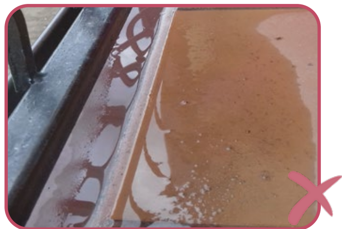
NIEWŁAŚCIWE ODPROWADZENIE WODY Z POSADZKI
