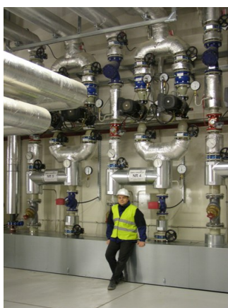
jedna ze zrealizowanych instalacji
