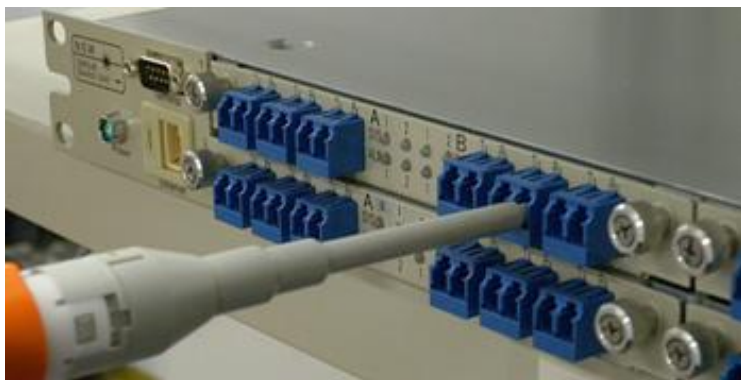
Czyszczenie wtyków LC w urządzeniu
