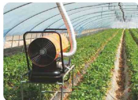
Nagrzewnica pracująca w szklarni
